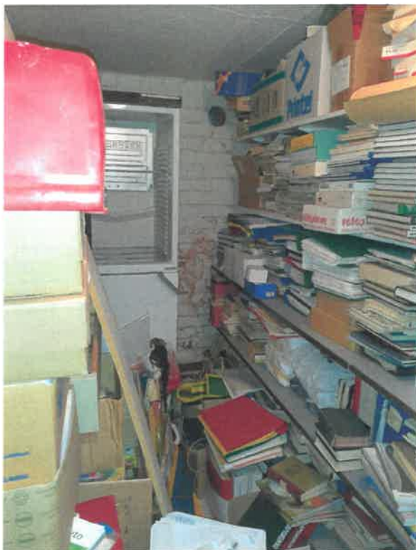
Anne Keltamäki 02.11.2023 09:47 Kosteuden aiheuttamia vaurioita seinärakenteissa
