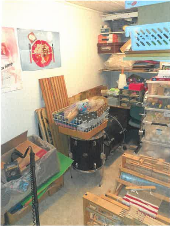
Anne Keltamäki 02.11.2023 09:31 Lattia 97, seinä 109. Lattiarakenne ja seinärakenteen alaosa kosteita.
