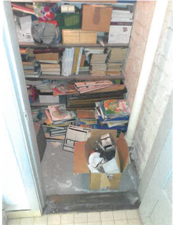
Anne Keltamäki 02.11.2023 09:47 Varasto. Lattiarakenteessa ja seinän alaosan rakenteessa on pintakosteusarvot koholla.
