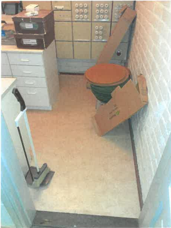
Anne Keltamäki 02.11.2023 10:01 Lattiarakenteessa ja seinän alaosissa pintakosteusarvot koholla
