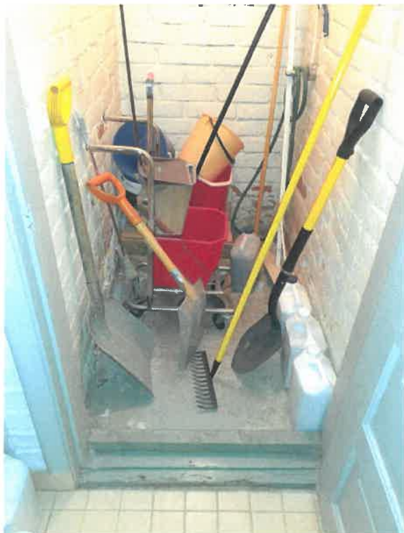
Anne Keltamäki 02.11.2023 09:47 Lattia- ja seinärakenteessa kosteuden aiheuttamia vaurioita.
