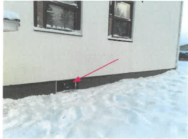
Anne Keltamäki 02.11.2023 10:04 Kellarin opetustilassa on korjaustyön aikana poistoilmapuhallin, joka puhaltaa ulos.
