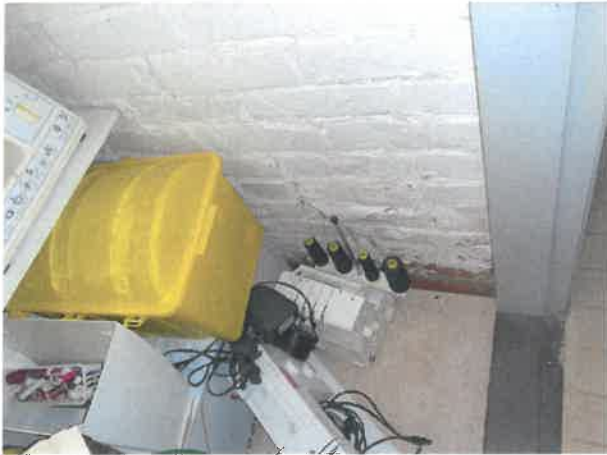
Anne Keltamäki 02.11.2023 09:46 Lattiarakenteessa ja seinän alaosan rakenteessa on pintakosteusarvot koholla.
