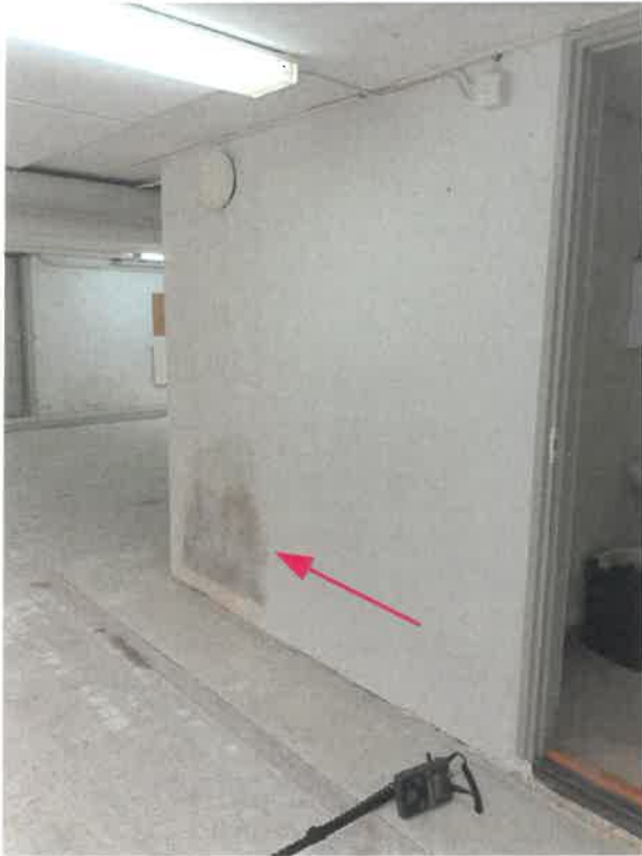
Anne Keltamäki 02.11.2023 09:27 Opetustilan ja wc1:n väliseinärakenteessa on paikallinen kosteusvaurioalue.
