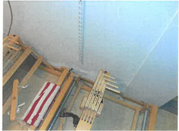
Anne Keltamäki 02.11.2023 09:31 Varasto. Kosteuden aiheuttamia vaurioita seinärakenteen alaosassa. Oven pielessä levyverhous, joka vaurioituu herkästi kosteuden vaikutuksesta.
