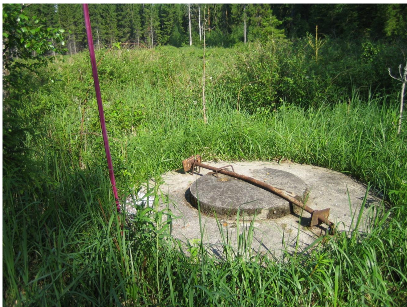
Kuva: Yksi Potikon vedenottamon lähdekaivoista
