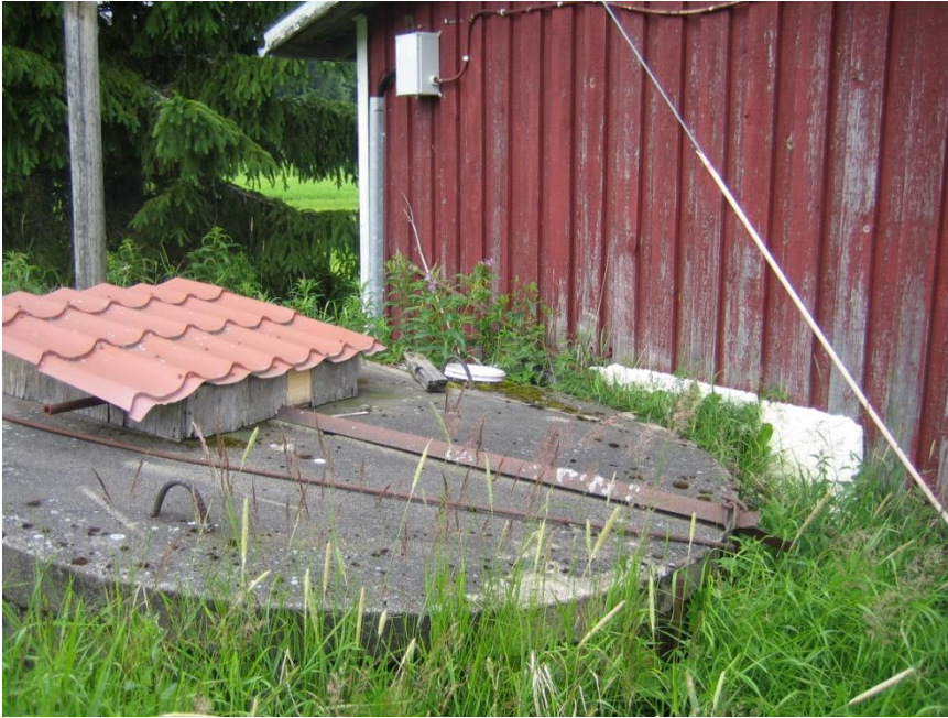
Kuva: Perälän vesihuolto Oy:n vedenottamo Pappilankankaan pohjavesialueella
